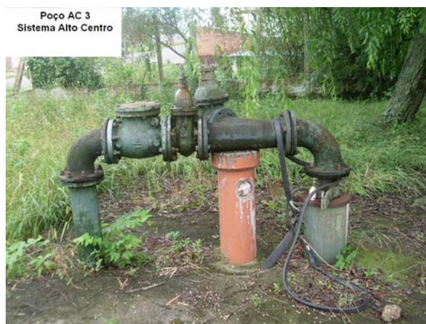
9 – Poço P-AC-03 (foto DAE)
