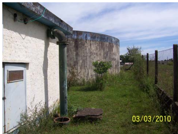
33 – Estação Elevatória EAT-AR-01 e Reservatório Apoiado RAP-AR-01
