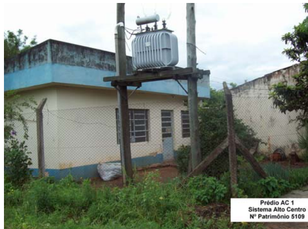
10 – Estação Elevatória EAT-AC-01 (foto DAE)
