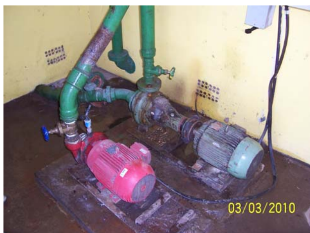
41 – Estação Elevatória Intermediária EPR-KE-01
