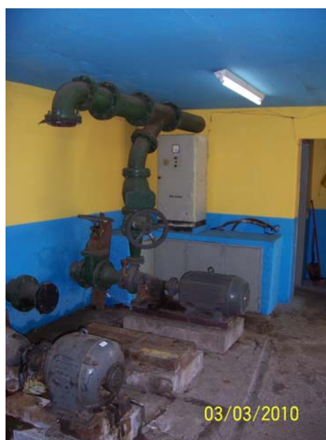
34 – Estação Elevatória EAT-AR-01
