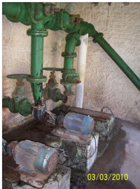
53 – Estação Elevatória EAT-AL-01
