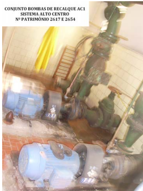
11 - Estação Elevatória EAT-AC-01 (foto DAE)
